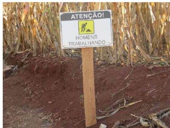
Figura 5.4: Placa de sinalização. Fonte: Construnível, 2020.
