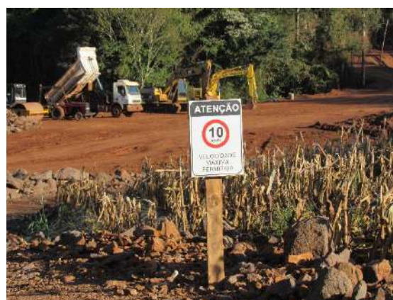
Figura 5.2: Placa de sinalização. Fonte: Construnível, 2020.
